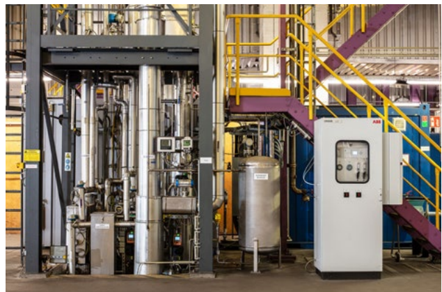
Die Anlage scheidet mithilfe eines Amin-Verfahrens aus den Rauchgasen der Eisenerzeugung Kohlendioxid ab, Foto: voestalpine Stahl GmbH
